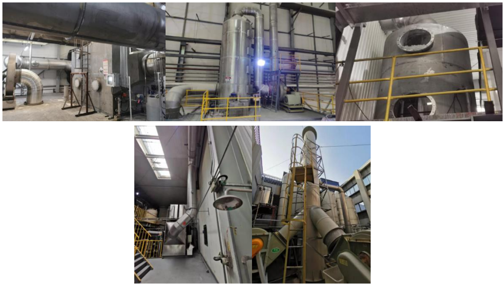
图.公司废气处理设施
