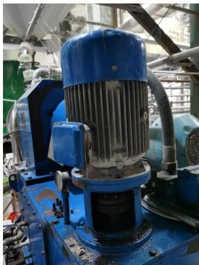
图：Y 系列电机更换前
